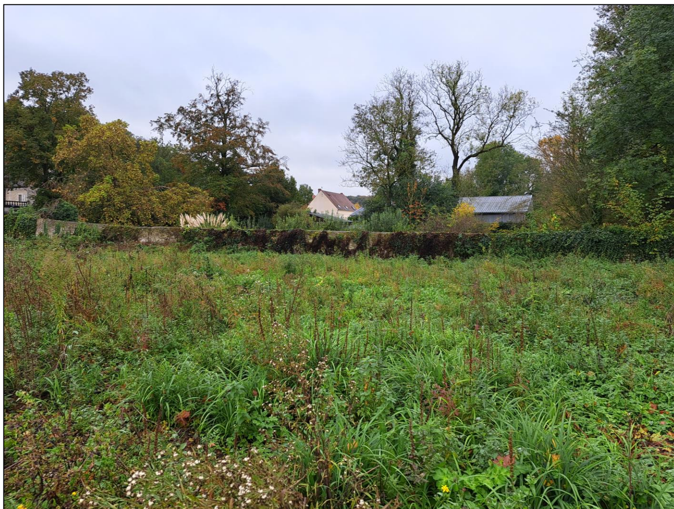
Figure 14 : Photographie du mur en béton au Sud du site (source : ECR ENVIRONNEMENT, octobre 2023)
